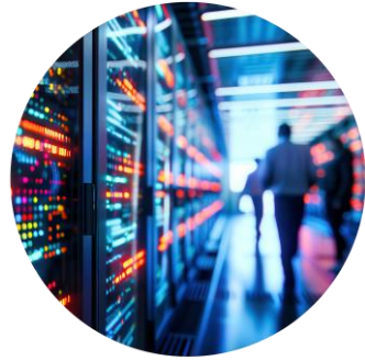
ศูนย์ข้อมูล (Data Center)
